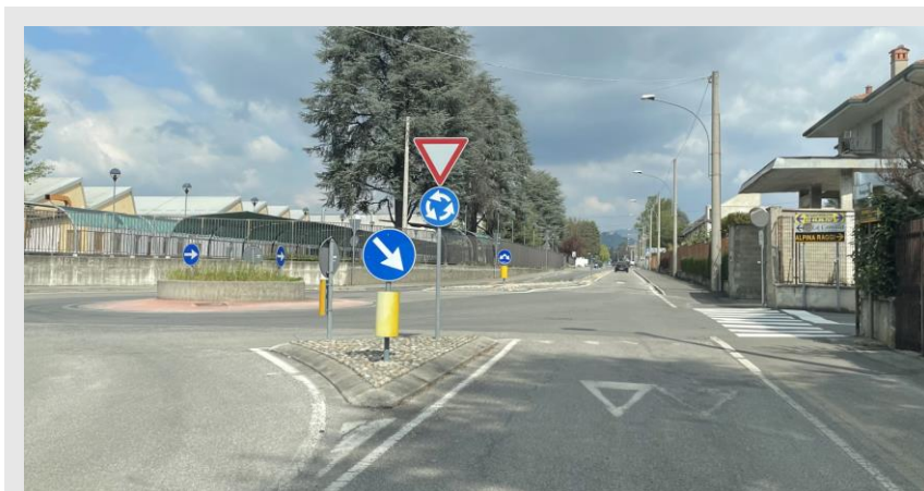
Anche la rotonda all'intersezione tra via Milano e via Piave è stata risolutiva; tuttavia se ad oggi la segnaletica verticale risulta ammalorata, il nodo pertanto necessita di un intervento di manutenzione.
